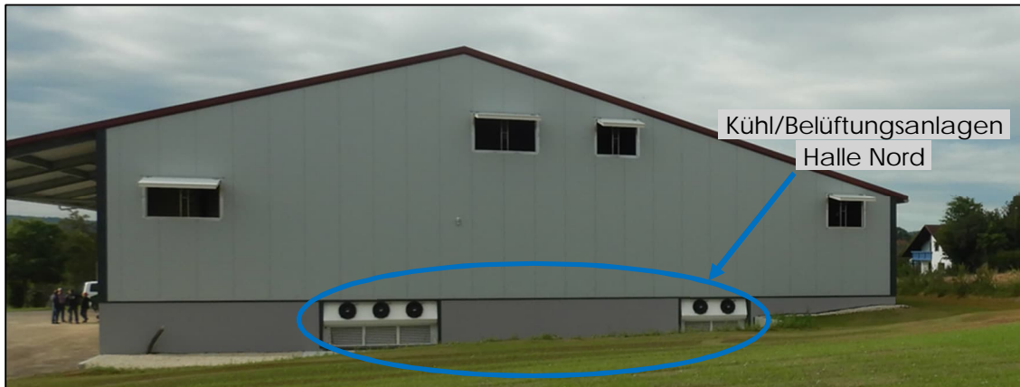
Abbildung 8: Technische Anlagen in der Nordfassade der neuen Kartoffellagerhalle /11/
