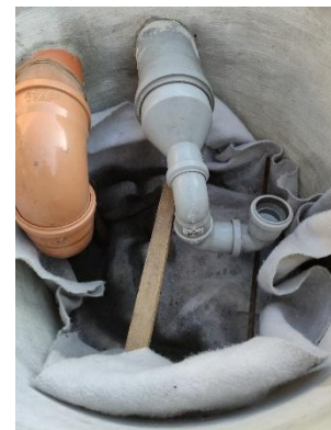
Filter für den Zulauf in die Zisterne. Dieser wird einmal jährlich gereinigt. Foto: Manfred Rhöner
