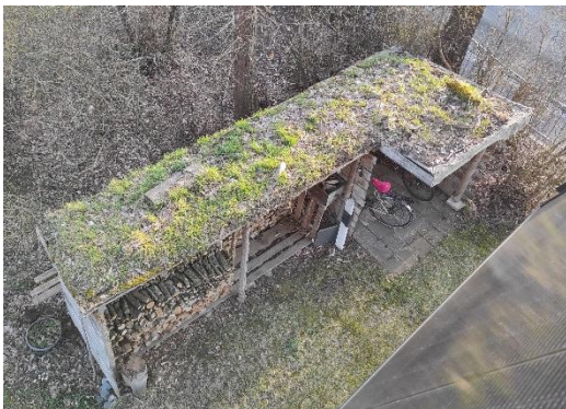
Praxisbeispiel: in Eigenleistung installiertes Gründach. Foto: Sabine Rhein.
