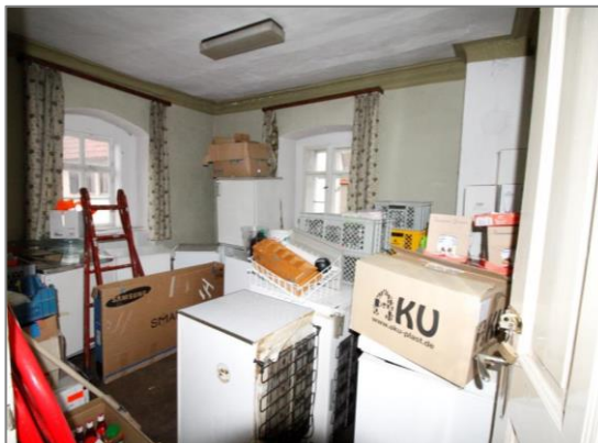
Zeile unten: Alte Einrichtung und ein vernachlässigter Eindruck kennzeichneten den Zustand vor der Sanierung.
