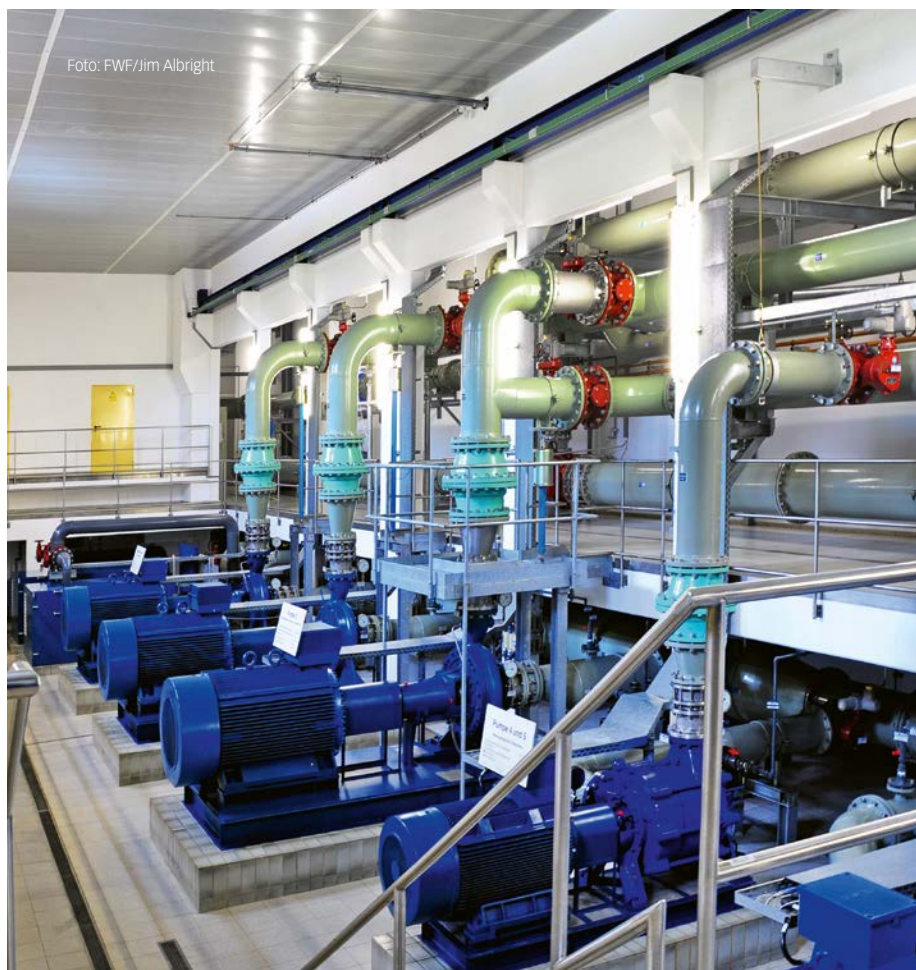
Diese Pumpen bilden das Kernstück der Wasserförderung.
