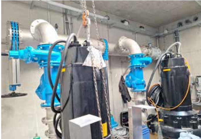
(Das Foto zeigt den Innenraum einer Pumpstation.)
