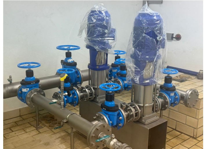
Bild: Druckpumpwerk Vorra
